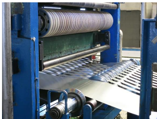
鋼材切断加工設備(フィリピン)
